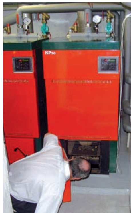
Nová kotelna ZŠ Písečná
